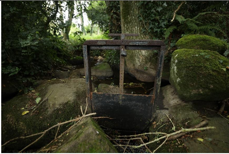
Photo 3 : Vanne hydraulique en position fermée dans le lit mineur du cours d'eau (photo : Erwan Stricot)
